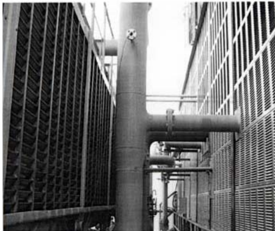
クーリングタワー 騒音対策施工例-2
